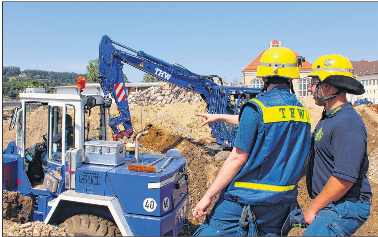
Mit Radlader und Bagger bahnen sich THW-Helfer einen Weg durch die Geröllmassen auf dem ehemaligen WCM-Gelände in Heidenheim. Dort war am Samstag eine groß angelegte Übung. (Foto: till)
